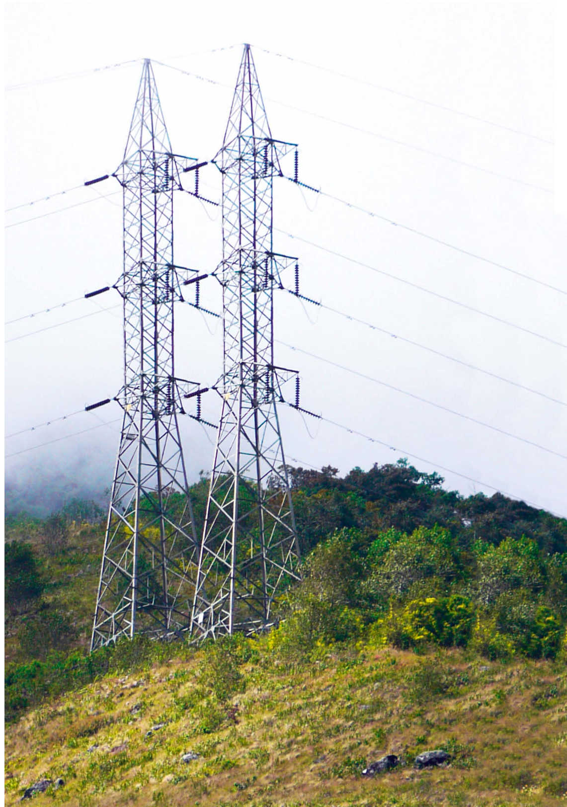
Líneas de Transmisión S.E. San Gabán II – S.E. Azángaro / Transmission Lines S. E. San Gaban II - S. E. Azángaro
