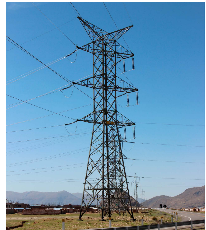
Línea de Transmisión S.E. San Gabán II - S.E. Azángaro / Transmission line S. E. San Gaban II - S. E. Azángaro
